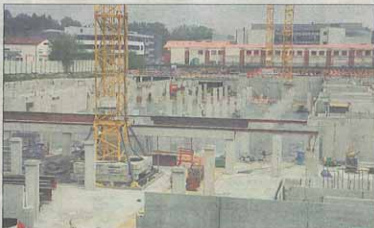
Les travaux de construction du projet Vertigo battent leur plein route d'Esch à Gasperich
